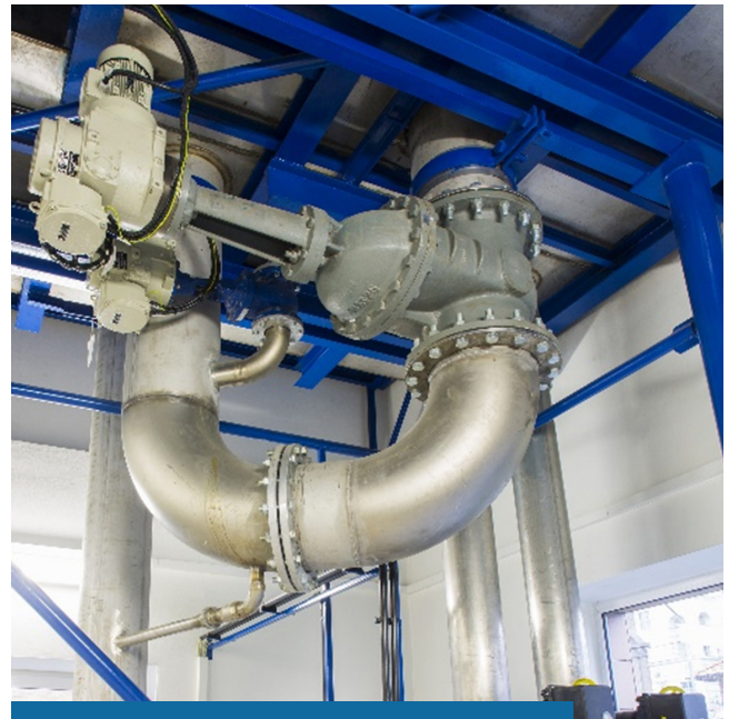
Armaturenraum des Wasserbaulabors Durchflusskapazität 230 l/s / TU Brno, CZ
