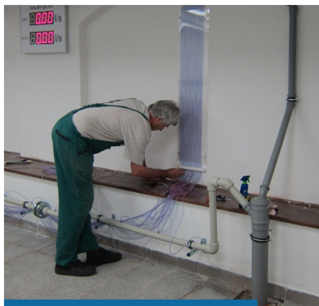
Aufbau des Rohrleitungssystems DN 50 für die Simulation der Druckverluste / Baufachschule Vysoké Mýto, CZ
