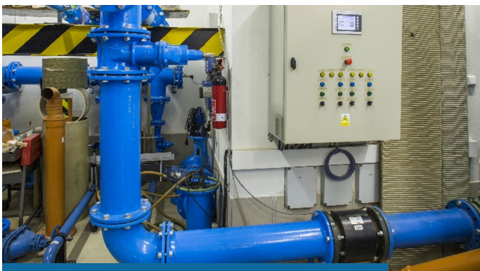
Schaltschrank der Pumpstation mit einem berührungsempfindlichen Bildschirm (Diagonale - 5,7") / TU Brno, CZ
