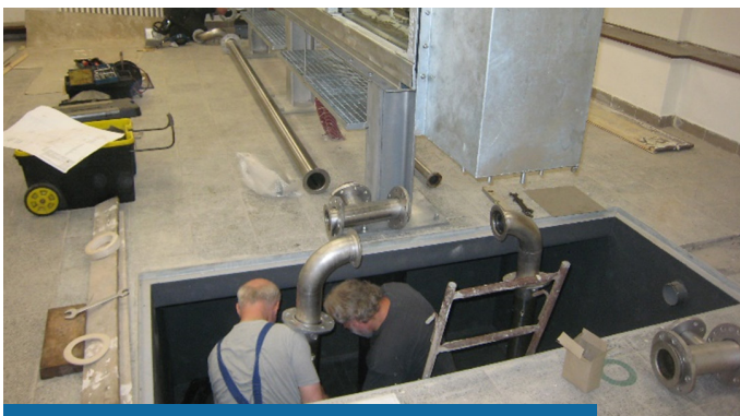
Leitungsaufbau des hydraulischen Kreislaufs Durchflusskapazität 36 l/s / Baufachschule Vysoké Mýto, CZ
