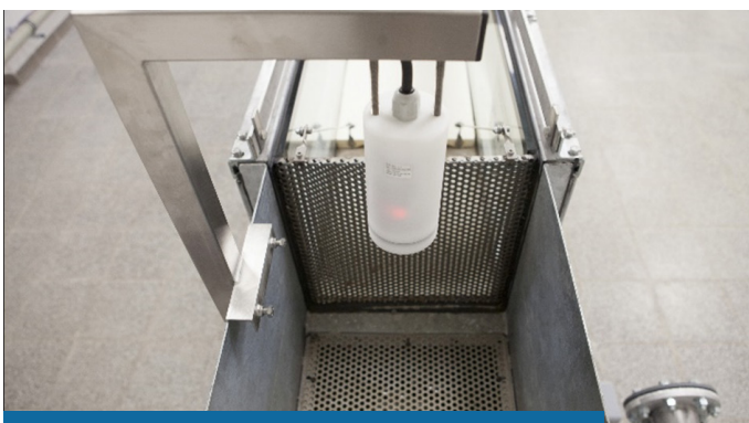
Zulaufelement der Rinne mit den Strömungsgleichrichtern und dem Lochblech
