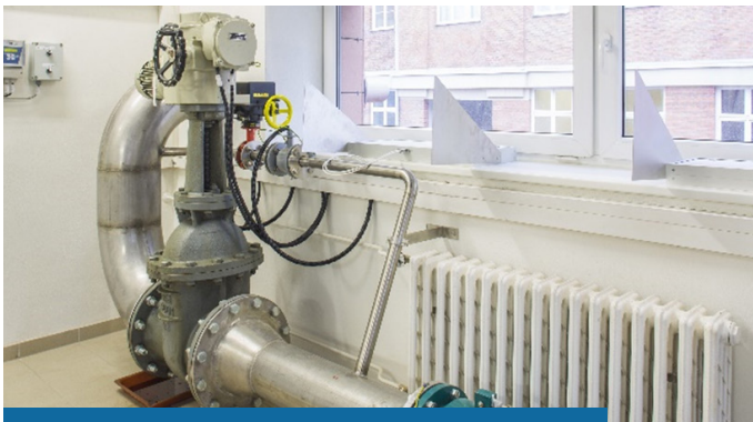
Leitungsteil der Armaturenraum des hydraulischen Kreislaufs, Durchflusskapazität 200 l/s / TU Brno, CZ
