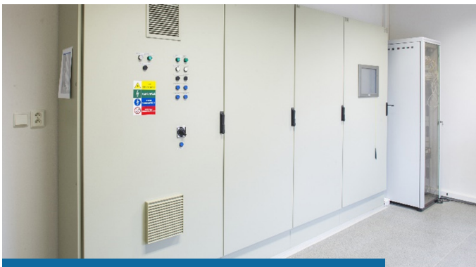
Schaltschrank des Kreislaufs mit einem berührungsempfindlichen Bildschirm (Diagonale - 15") / TU Brno, CZ
