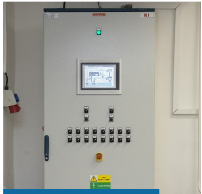
Schaltschrank des Wasserbaulabors mit einem berührungsempfindlichen Bildschirm (Diagonale - 10") / Baufachschule Vysoké Mýto, CZ
